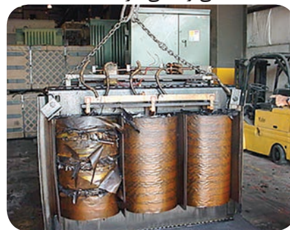
شکل ۷: خرابی یکسوساز دیودی ناشی از استفاده روغن نامناسب
